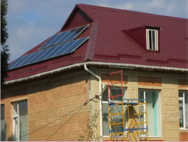
Енергозберігаючі заходи в ДНЗ «Сонечко» в смт Томашпіль, Томашпільського району, Вінницької області
